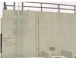
妥善維修的水管
