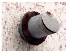
設有自閉封蓋的溢流管
