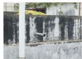
無封蓋的溢流管
