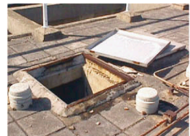
水箱箱蓋已損毀
