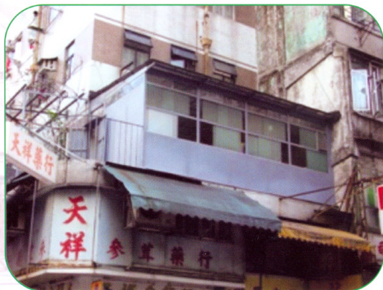
在石屎簷篷上加建僭建物，會更易引致倒塌意外
