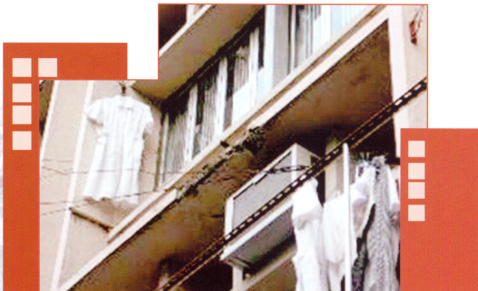
外牆剝落對行人可構成嚴重危險
