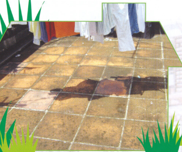
如天面防水層狀況差劣，最佳的維修方法是全面重鋪天台
