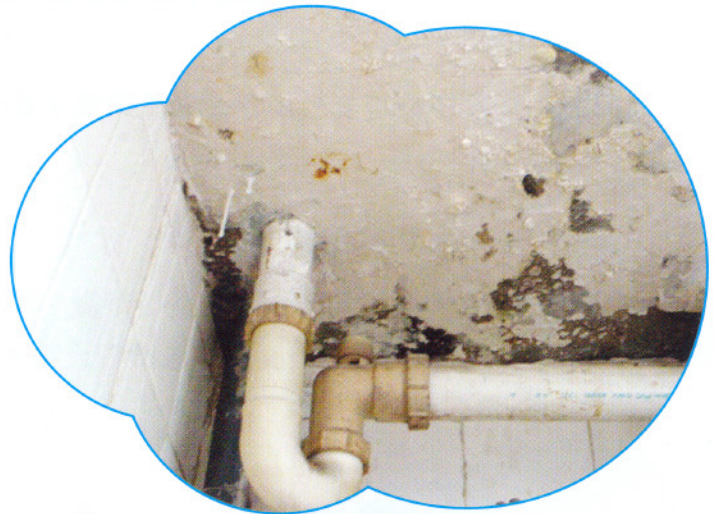
浴室地台去水邊位及渠邊漏水會引致浴室天花滲水
