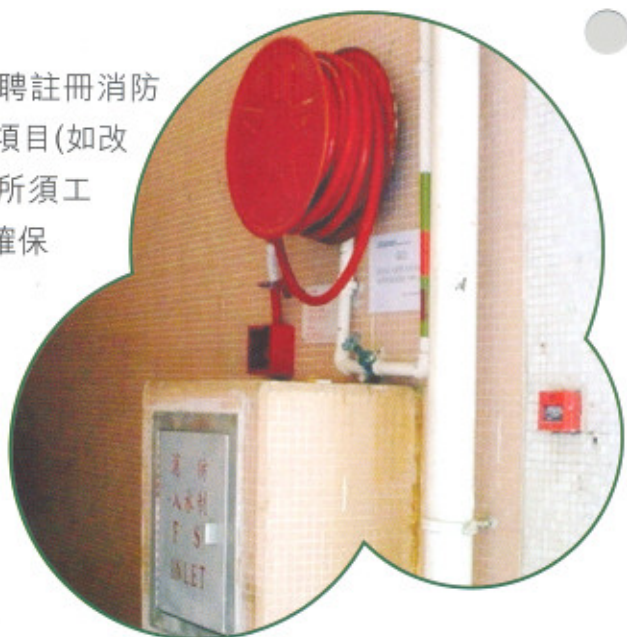
改善大廈的消防裝置及設備，業主應聘註冊消防裝置承辦商進行有關工程
