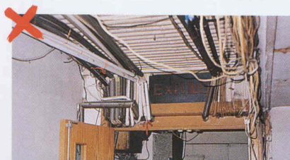
樓梯內的設施沒有妥為保護
