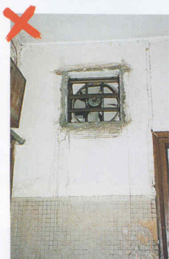
擅自在耐火牆上開設通口並安裝抽氣扇
