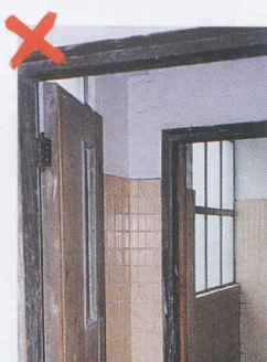
消防門損毀 / 不見了
