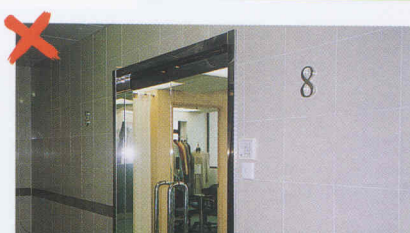
開向公用走廊的門耐火能力不足
